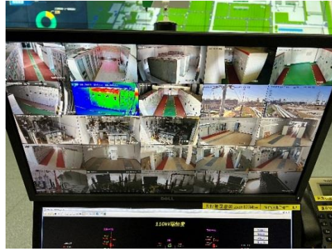
变电站控制系统
